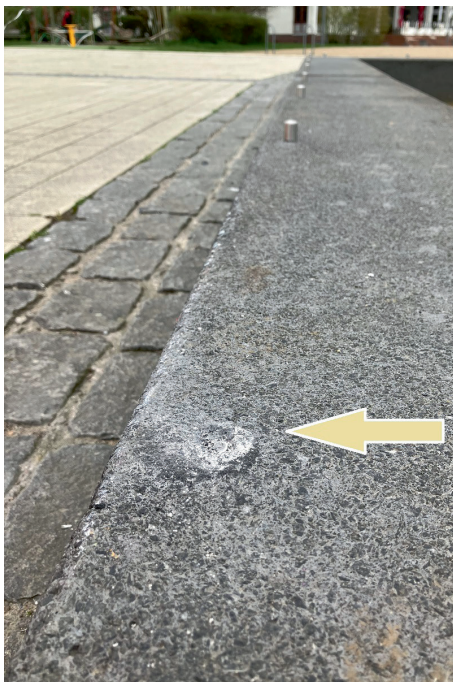
Anti-Skate-Stopper auf der Einfassungs-Mauer am Stadthafen wurden mutwillig zerstört
