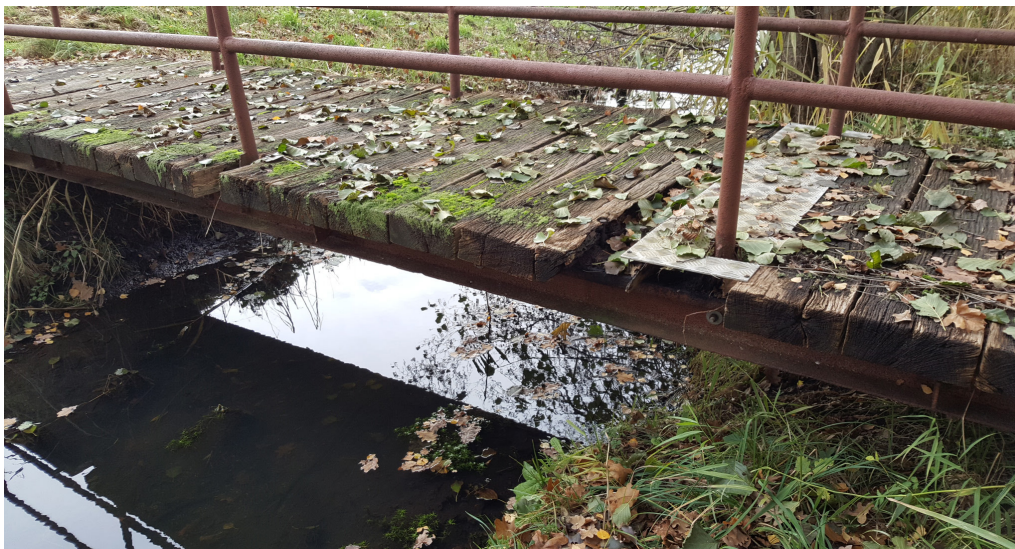
Die Beschädigungen an den Bohlen der Krebsbachbrücke sind deutlich zu erkennen
